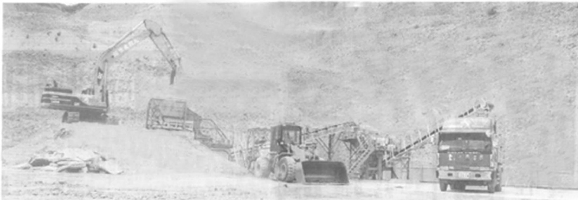
＝ リサイクルプラント全景 ＝
